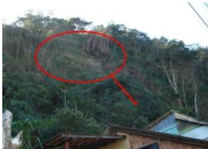
Foto 3.2 – Camada de solo sobre rocha e blocos soltos sobre a moradia
