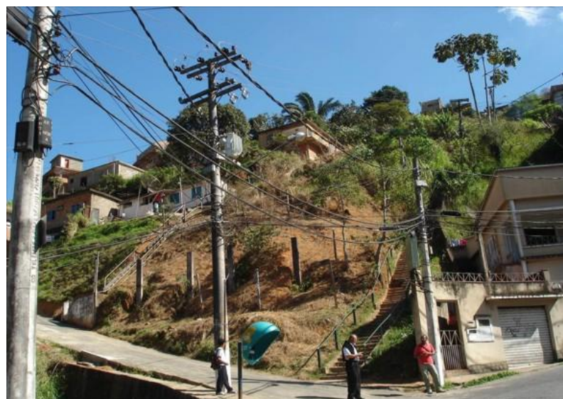
Foto 3.12 – Encosta sem proteção superficial – alteração antrópica.
