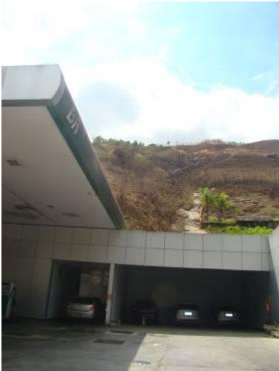
Foto 005 – Construções nas linhas de drenagens.
